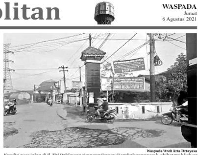
Waspada/Andi Arta Tirayasa Kondisi ruas jalan di Jl. Titi Pahlawan simpang Danau Siombak yang rusak akibat truk keluar masuk dari gudang, dengan ada di kawasan tersebut.
